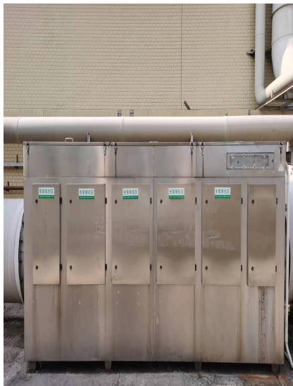
臭气处理设施
