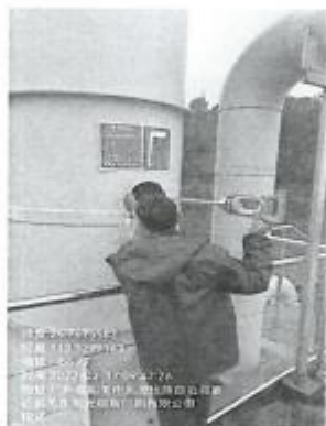
污水处理站废气处理后排放口 (DA012)
