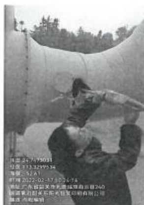
污水处理站废气处理前检测口 (DA012)
