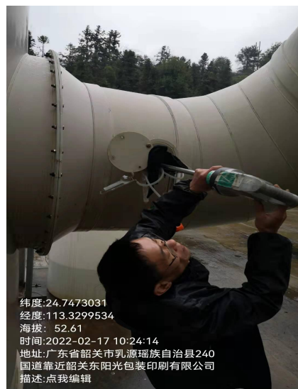
污水处理站废气处理前检测口 (DA012)
